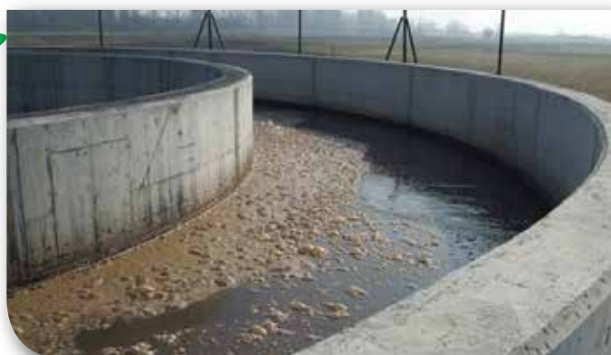
Bazen na čistilni napravi Obrežje.
