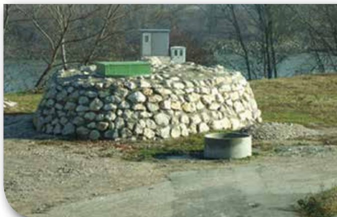
Kanalizacijsko prečrpavališče Jesenice na Dolenjskem.
